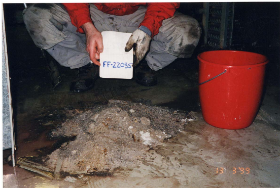
Första bilden visar ett värmeväxlingsbatteri innan rengöring. Andra bilden visar hur mycket smuts man tog bort.
